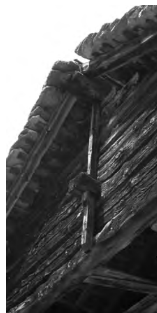
Stubbi Particolare del sistema di irrigidimento del frontone con chiavi Détail du raidissement du fronton avec des clés Detail der Giebelbefestigung mit Schwertkeilen
